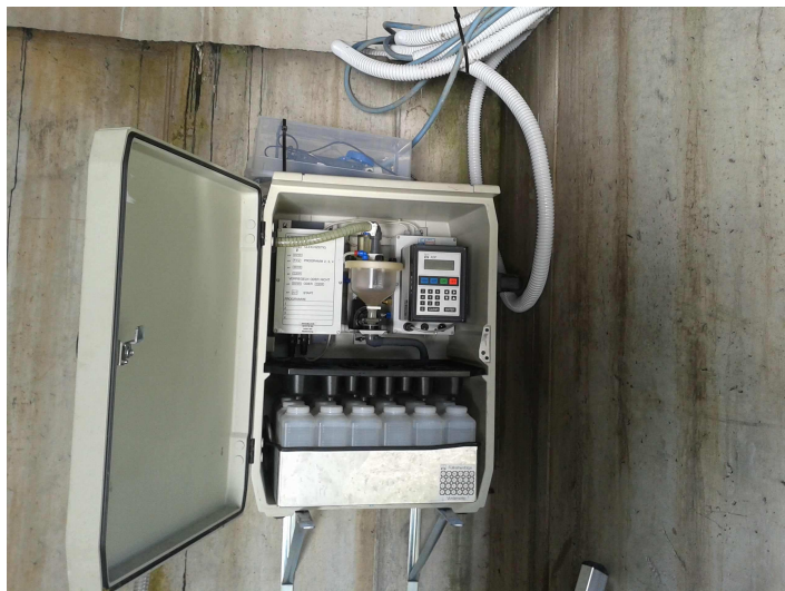
Fig. 9: Il campionatore automatico installato nella stazione P3
