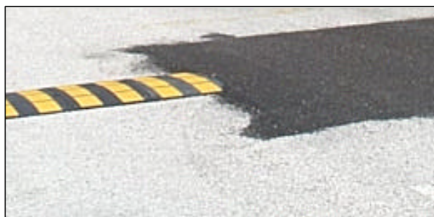
FIGURA 9. Dossi prefabbricati e costruiti in opera
