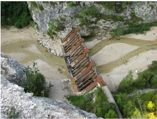
Briglia filtrante costruita sul Torrente Leno di Terragnolo per trattenere i materiali grossolani (massi, tronchi e altro) durante le piene.
