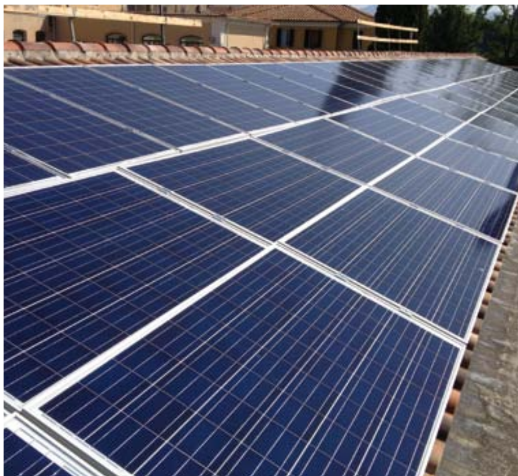
Pannello solare fotovoltaico su scuola, Comune di Magliano Sabina (RI)
