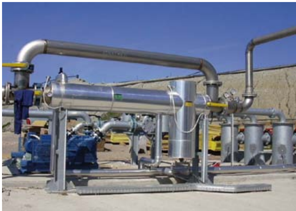
Particolare impianto di captazione biogas, Provincia di Siena
