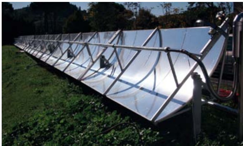
Impianto solare a concentrazione, Comune di Firenze
