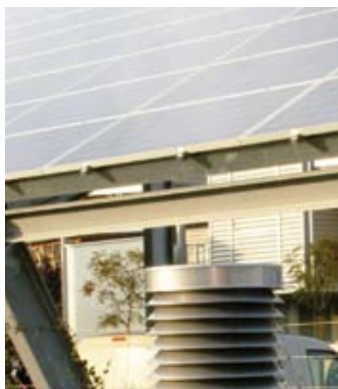
Impianto solare fotovoltaico su pensilina Comune di Conselice (RA)
