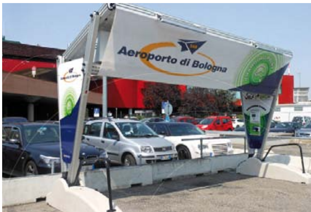
Sistema di ricarica auto con pannelli solari fotovoltaici, Aeroporto di Bologna
