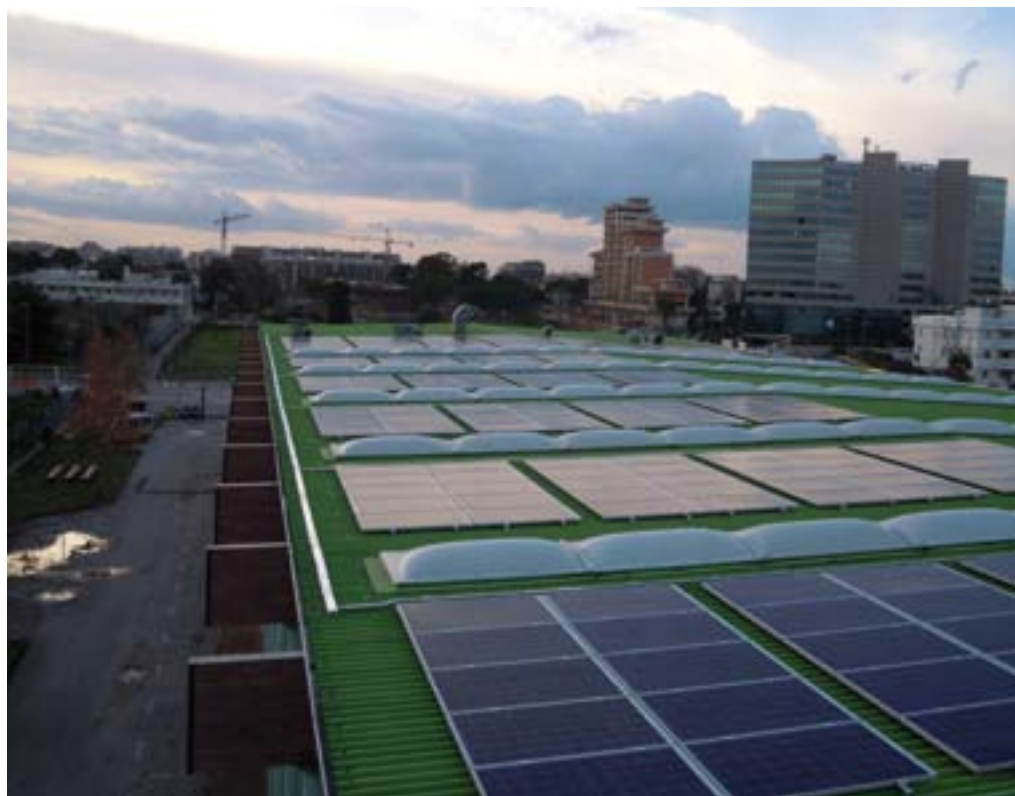
Impianto fotovoltaico su edificio pubblico, Comune di Bari
