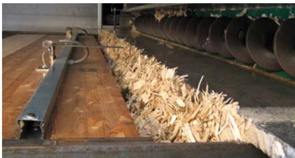
Impianto per lo sminuzzamento della biomassa solida
