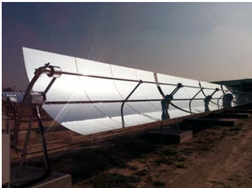
Impianto solare a concentrazione Comune di Forlì (FC)
