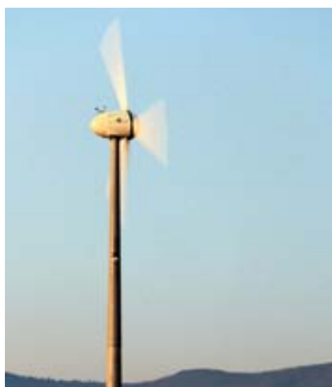
Impianto mini eolico, Porto di Savona
