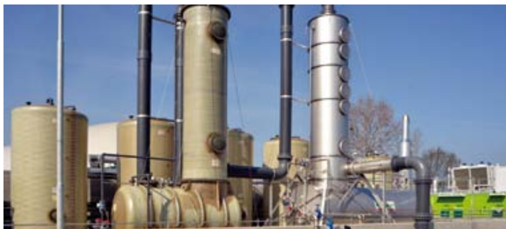
Impianto a biogas, Comune di Vottignasco (CN)
