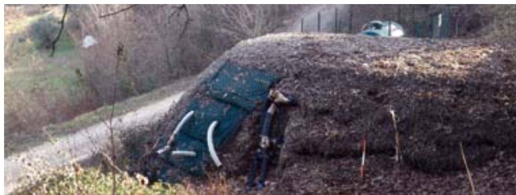
Impianto termico da materiale organico, Comune di Gubbio (PG)
