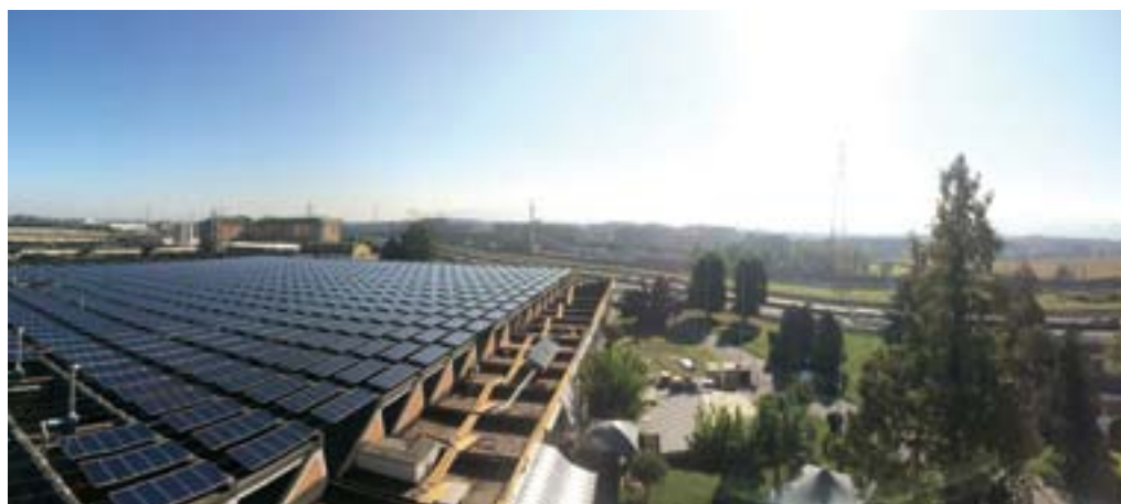
Impianto solare fotovoltaico su stabilimento industriale L'Oreal
