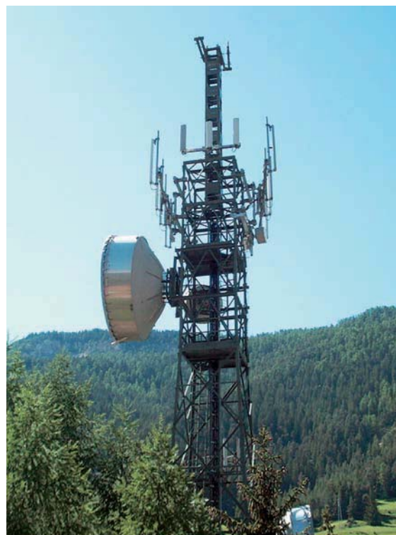
Figura 3: esempio di tipologia di impianto per telefonia mobile
