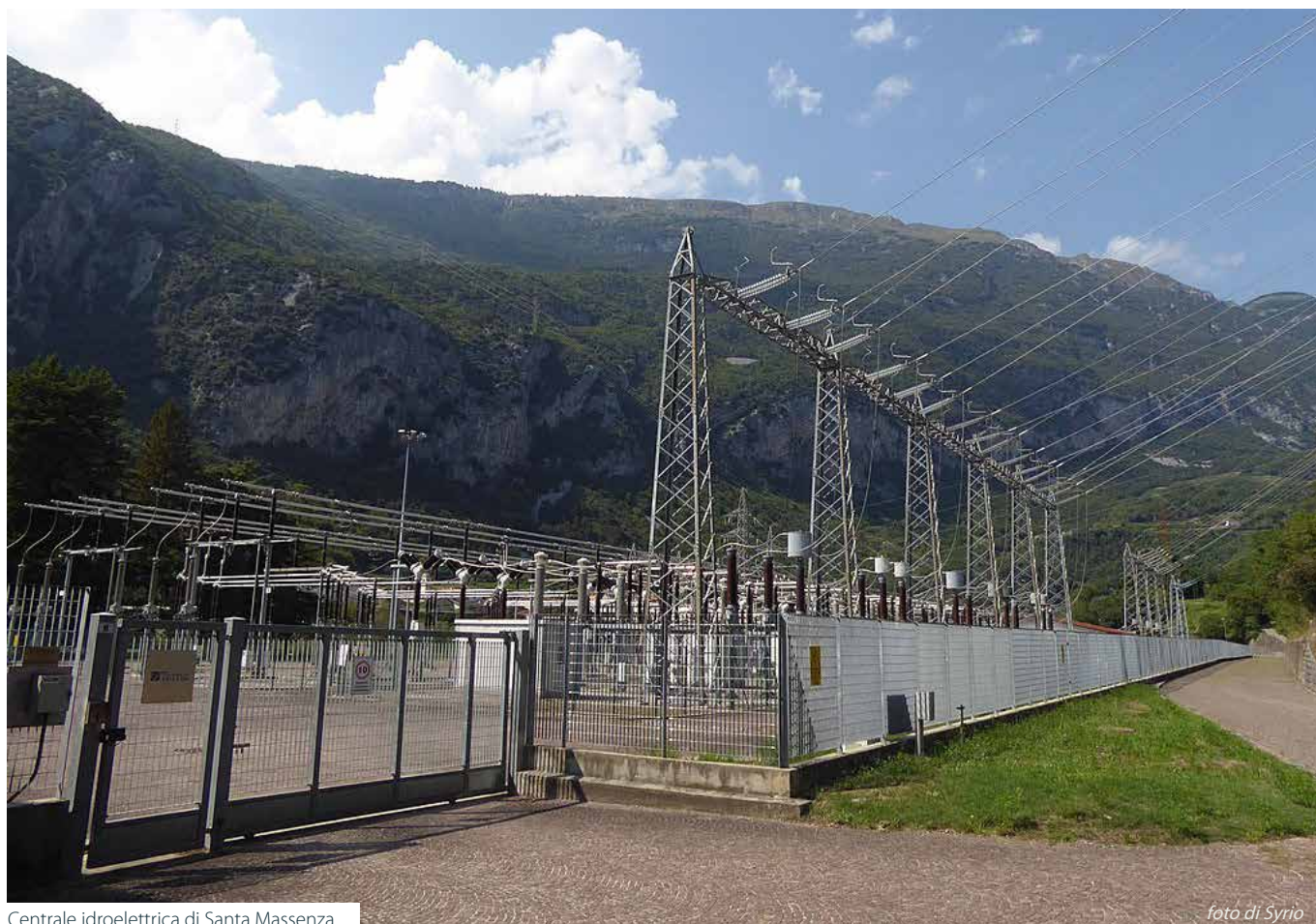
Centrale idroelettrica di Santa Massenza
